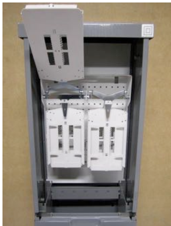
Figur 20, Exempel på skarvskåp i byggnad
